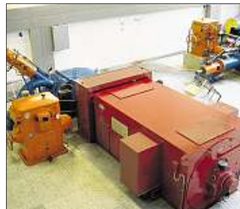
Blick in das Innere des Kraftwerkes Luchsingen.
